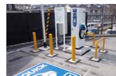
エネルギーステーション
