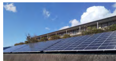
生駒市民共同発電所5号機
